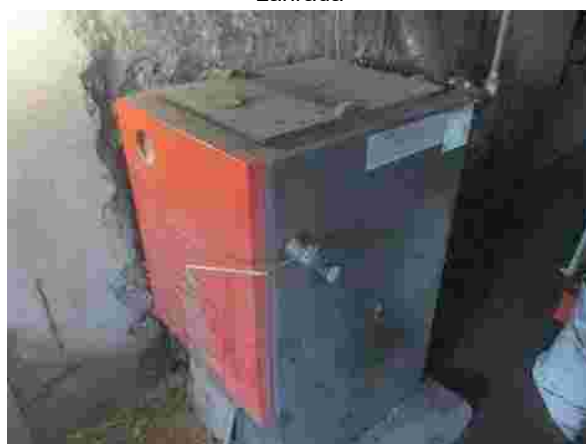
kotel ve sklepe
